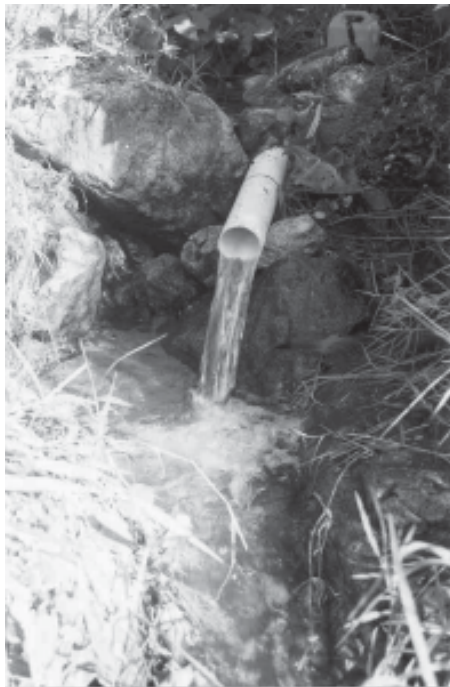
FIGURA 4. MANANTIAL “LA CIÉNEGA” EL FLUJO MEDIDO ES DE 8 LITROS POR SEGUNDOS, SIN QUE TENGA USO ALGUNO. PROVIENE DEL SISTEMA DE FALLAMIENTOS-FRACTURAMIENTOS DE ROCAS GNÉISICAS Y GRANÍTICAS.
